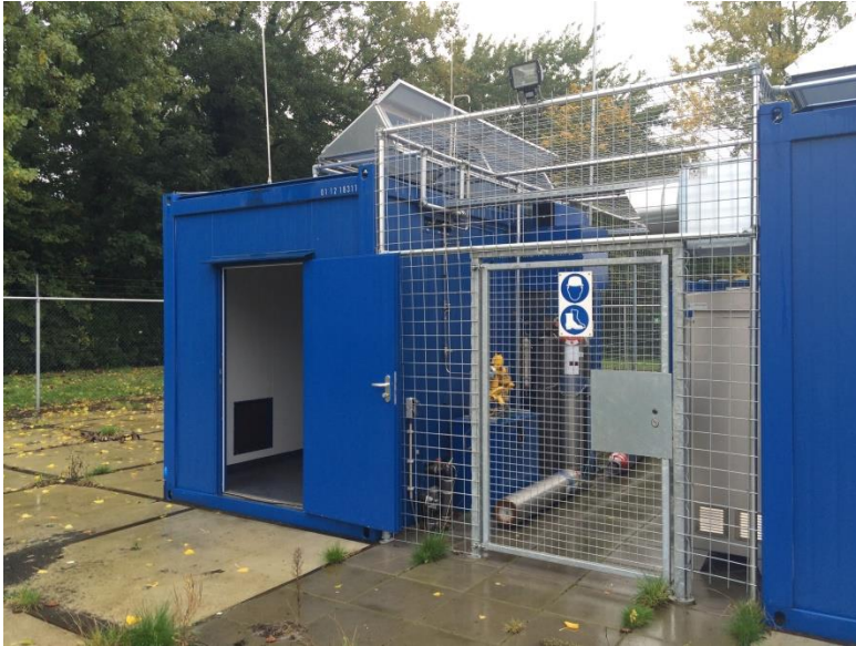
Figuur 20 Containers voor de Power to Gas installatie in Rozenburg (eigen opname)
