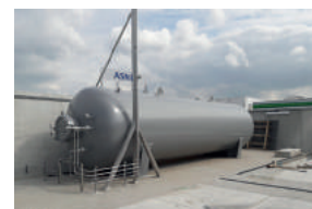
Liggende opslagtank 80 bar (Kerkhof)
