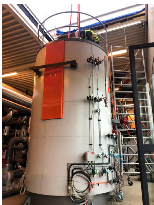
Figuur 17 E-boiler Ypenburg als onderdeel van het Haagse Stadswarmtenet (Eneco, 2020)
